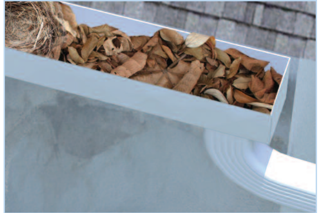
Una canaleta obstruida puede convertirse en un refugio para las plagas y evitar que drene adecuadamente hacia el exterior.
